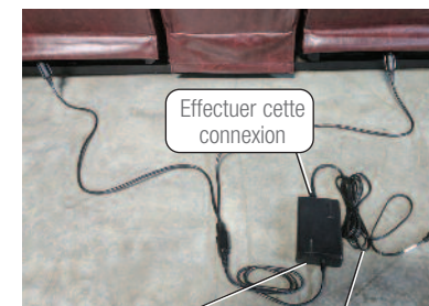
Transformateur électrique Cordon d'alimentation de 120 volts
